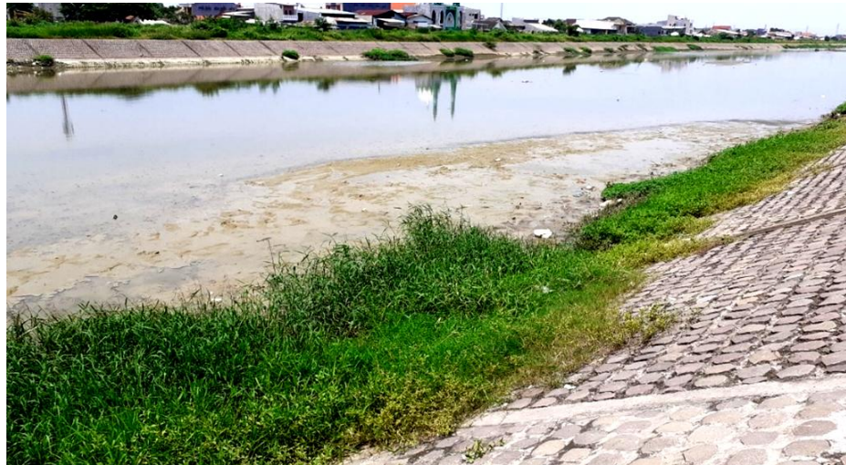
Gambar 4.79. Revetmen & Sedimentasi STA 3+200
