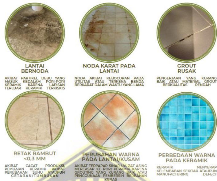
Gambar 2.6 Jenis Kerusakan Ringan Pada Lantai Sumber : Buku Pedoman Survei Kerusakan Bangunan
