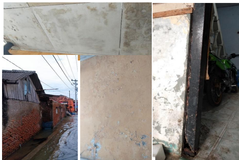
Gambar 4.16 Kerusakan Fisik Komponen Arsitektur
