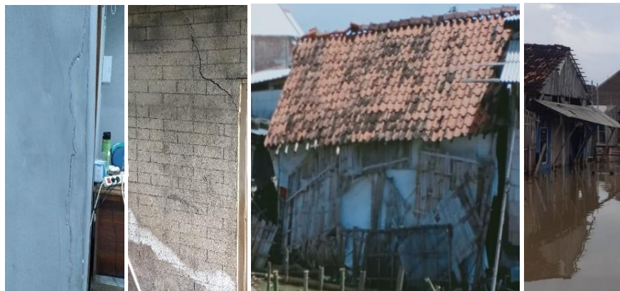
Gambar 4.15 Kerusakan Fisik Komponen Struktur
