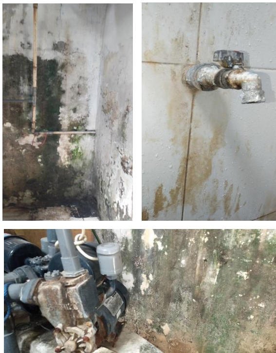
Gambar 4.17 Kerusakan Fisik Komponen Utilitas
