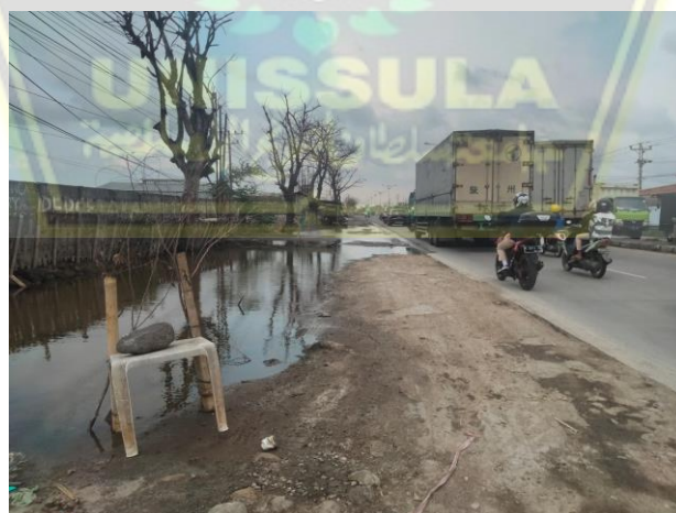
Gambar 4.1 Drainase yang sudah tidak mampu menampung debit air
