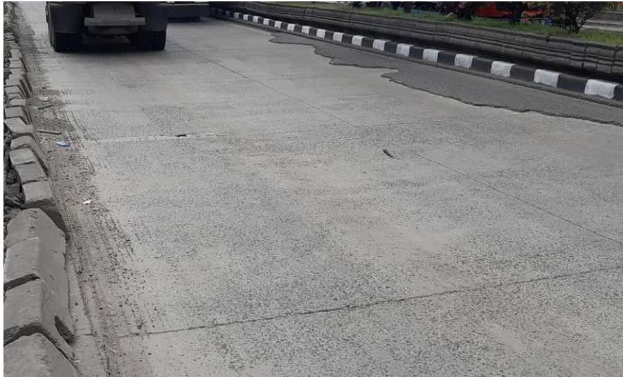
Gambar 4.5. Hasil Survei Kondisi Jalan STA 2+100, terjadi pengelupasan lapisan atas aspal yang lebih parah dari gambar 4.4 (Sumber : Data Primer)
