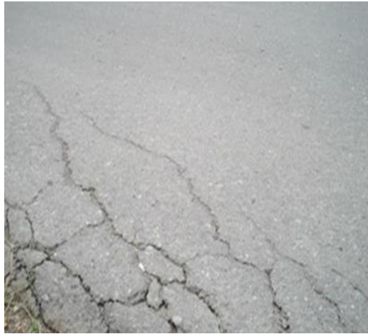
Gambar 2. 3 Retak Pinggir ( Edge Cracks )
