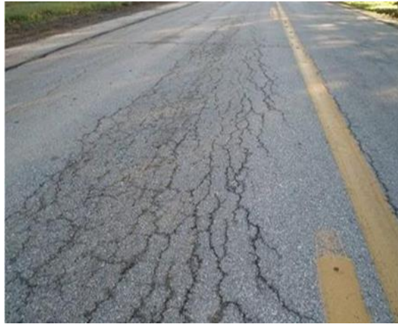
Gambar 2. 9 Retak Strukturan ( Structural Cracking )
