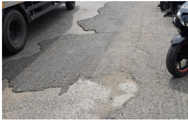
Gambar 4.3. Kondisi Permukaan Jalan STA 2+000, terdapat pengelupasan lapisan atas membuat permukaan jalan tidak rata (Sumber : Data Primer)
