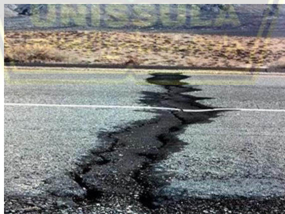
Gambar 2. 10 Retak Thermal ( Transverse Thermal Cracking )
