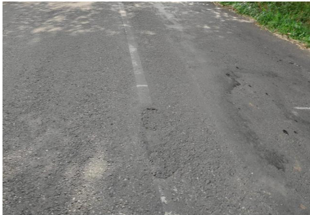
Gambar 4.3 Retak selip ( Slippage Cracking ) di ruas jalan Weleri – Patean ( Data Primer yang Diolah, 2022 )
