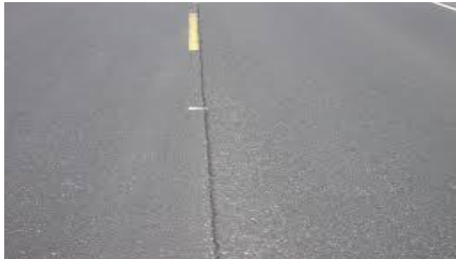
Gambar 2.7 Retak sambungan jalan
