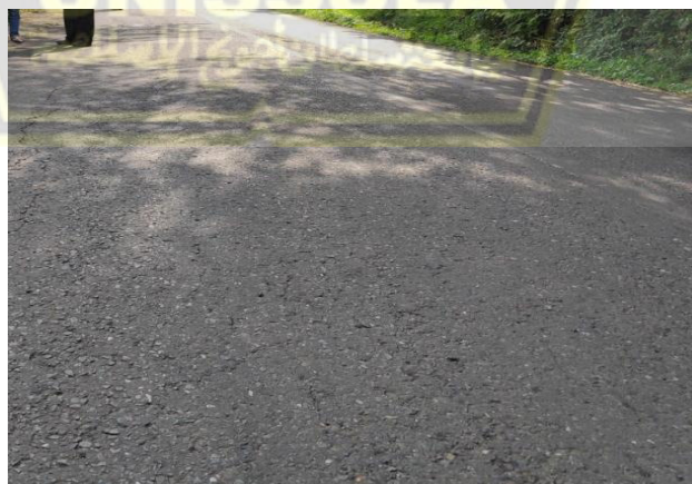
Gambar 4.1 Retak halus ( Hair Cracking ) di ruas jalan Weleri – Patean (Data Primer yang Diolah, 2022)
