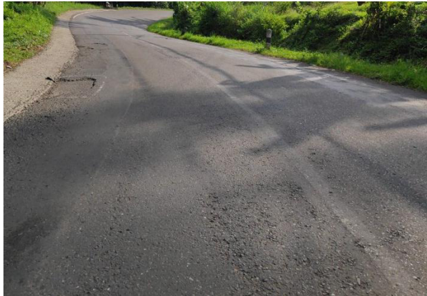
Gambar 4.4 Alur ( Ruts ) di ruas jalan Weleri – Patean ( Data Primer yang Diolah, 2022 )
