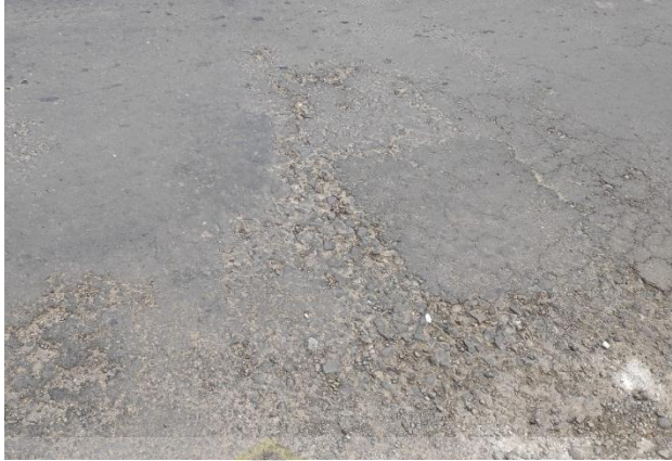
Gambar 4.8 Pengelupasan lapis permukaan ( Stripping ) di ruas jalan Weleri – Patean (Data Primer yang Diolah, 2022)
