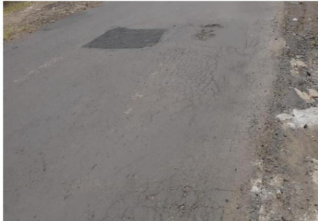
Gambar 4.2. Retak kulit buaya ( Alligator Cracking ) di ruas jalan Weleri – Patean
