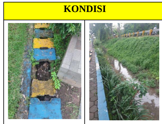
Gambar 4.19 Kondisi Selokan Di Area Taman
