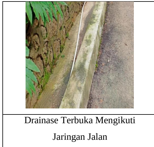
Gambar 3. 27 Drainase di Desa Wisata Wonosoco
