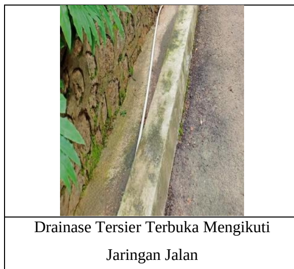
Gambar 4. 3 Drainase di Desa Wisata Wonosoco
