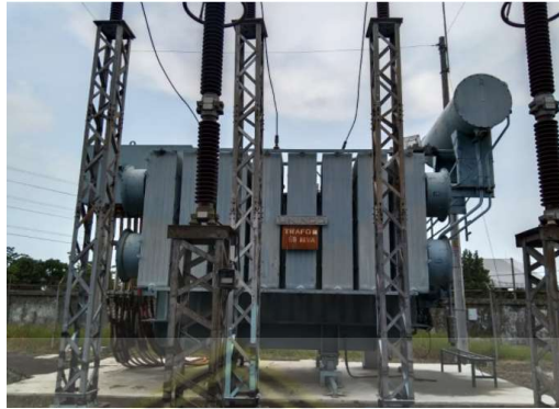
Gambar 2.7 Trafo Tenaga 150 kV / 20 kV GI Kalibakal
