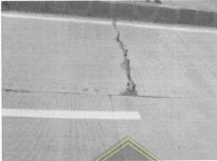
Gambar 2.9 Retak melintang ( transverse crack )
