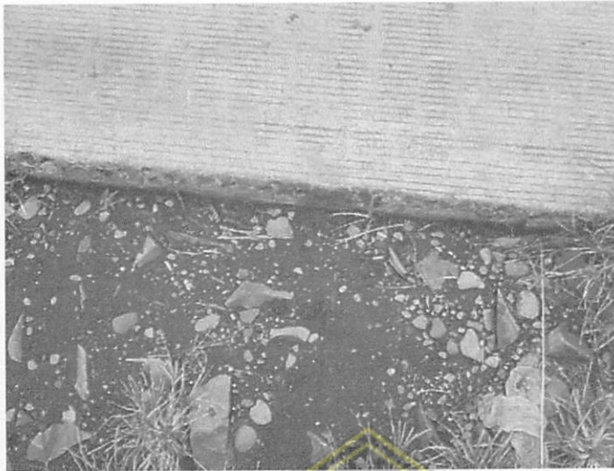
Gambar 2.12 Penurunan bagian tepi perkerasan
