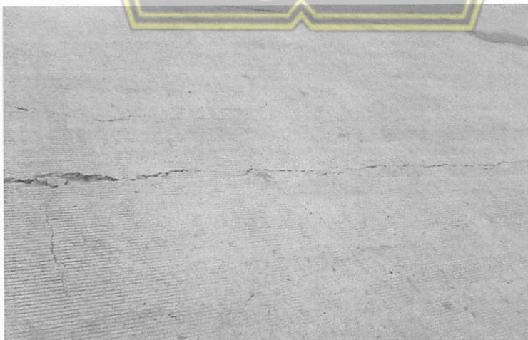
Gambar 2.7 Retak memanjang ( longitudinal crack )
