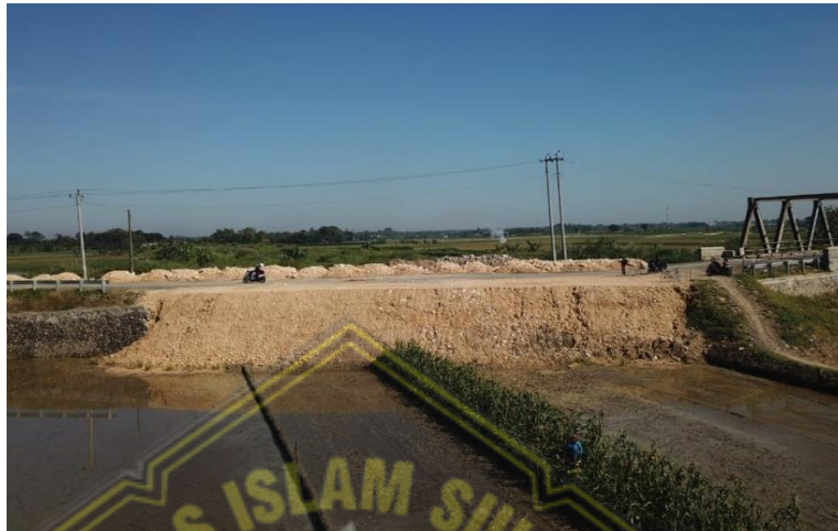
Gambar 4. 1. Lokasi DPT yang longsor
