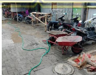
IPAL Komunal yang terletak di RT 1 – RW 24, terdapat banyak tutup lingkaran yang nantinya difungsikan untuk menyedot apabila kondisi IPAL penuh
