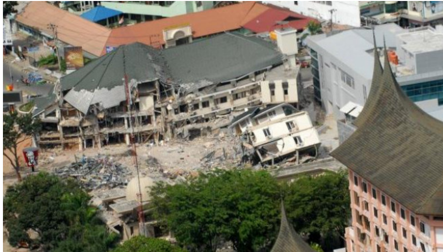
Gambar 1-3. Bangunan bertingkat yang miring karena penurunan pondasi akibat likuifaksi saat gempa bumi di Padang
