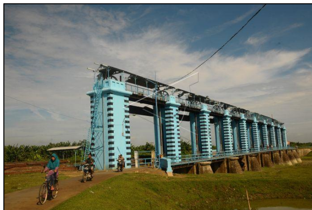
Gambar 1.2 Pintu Banjir Wilalung
