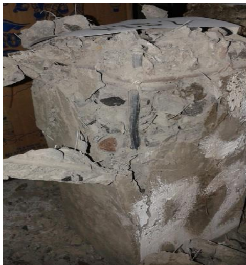
Gambar 15. Tulangan lateral yang masih utuh dan cukup baik menunjukkan adanya efektifitas tulangan dalam meningkatkan daktilitas beton terkekang
