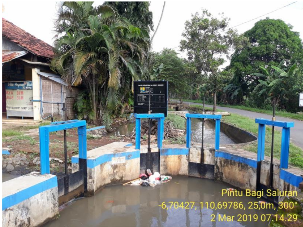
Foto 9. Pintu Bagi Saluran Irigasi
