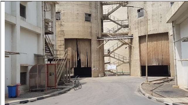
Fly Ash Silo Bunker A dan B
