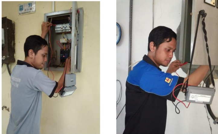
Gambar 4.1 Pengukuran Tahanan Isolasi Pada MDP
